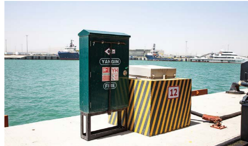
Yeni Bakı Beynəlxalq Dəniz Ticarət Limanı. Elektrik yarımstansiyası Ələt qəs., AZƏRBAYCAN RESPUBLİKASI
